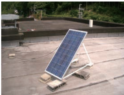
図-11 屋上に設置したソーラーパネル
