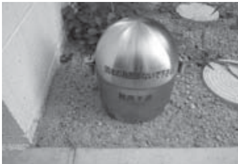
散水栓（雨水再生水設備）
